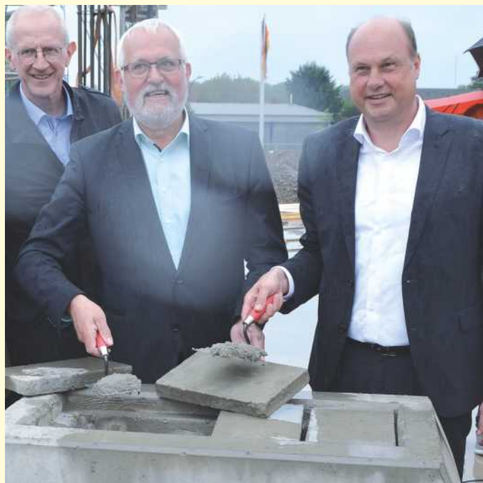
Wie es sich für gute Bauherren gehört, legten Guido Maßmann (re.) und Bernhard Loch mit einer guten Kelle Maurerspeis beim Verschließen des Grundsteins mit der Zeitkapsel selber Hand an.
