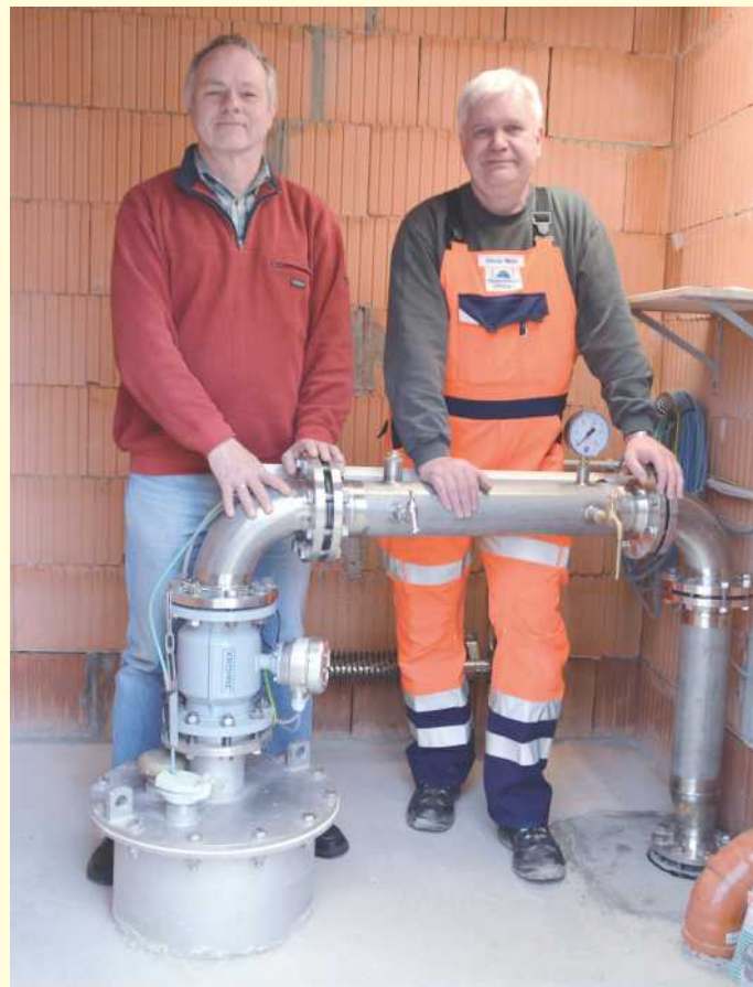
„Wasser marsch“ mit neuen Rohren und neuer Pumpentechnik: Diplomingenieur Horst Kipp (li.), technischer Leiter beim Wasserverband Wittlage, und Wasserwerker Ottmar Meyer in der neuen „Brunnenstube“ des Trinkwasserbrunnens 1 auf dem Belmer Wasserwerk. Zwei Jahre lang war der Brunnen wegen undichter Rohre vom Netz gewesen. Foto: Gemeinde Belm/D. Meyer
